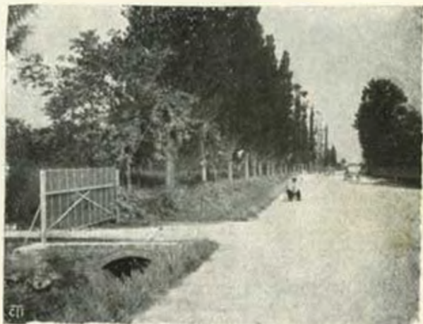
Tronco di strada cilindrata sulla Persicotana: tutto il percorso dopo la cilindatura sarà incatramato.
